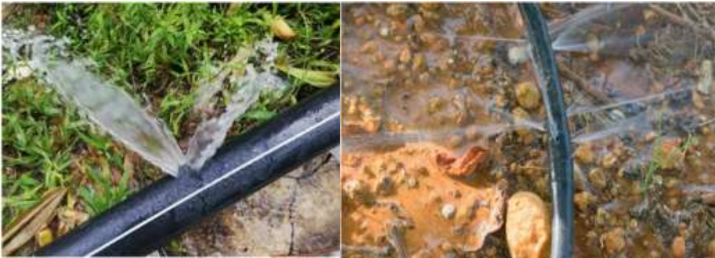
Şekil 7. Damla sulama boru yırtıkları (Anonim 2024c).
